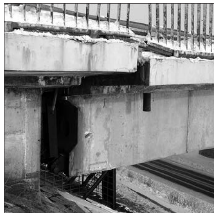
Sulūžęs tiltas per Nerį ties Kaunu.
